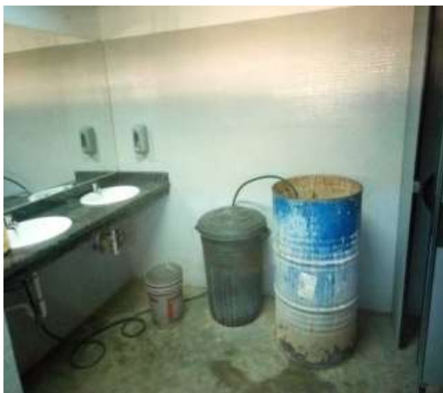
Baños sin servicio de agua
