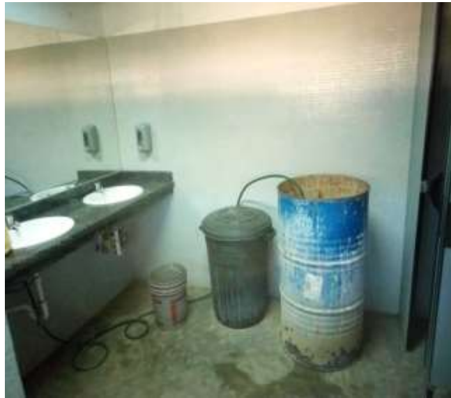
Baños sin servicio de agua
